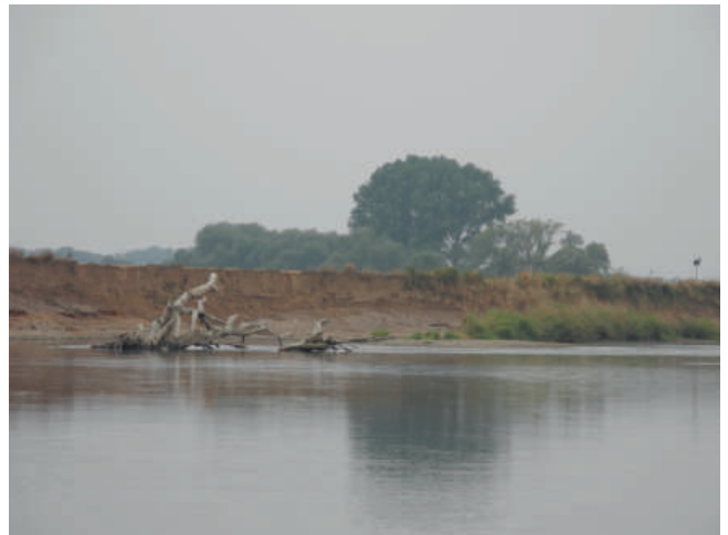
Foto 58: Uferabbruch im Bereich einer Totholzansammlung an der Mulde (Foto: A. Stowasser)
