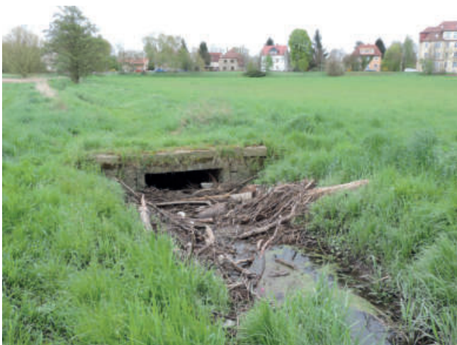
Foto 95: Treibgutansammlung aus Totholz. An Brücken und Durchlässen sowie im Bereich von Gebäuden, Verkehrswegen und Infrastruktureinrichtungen ist eine Beräumung erforderlich. (Foto: A. Stowasser)
