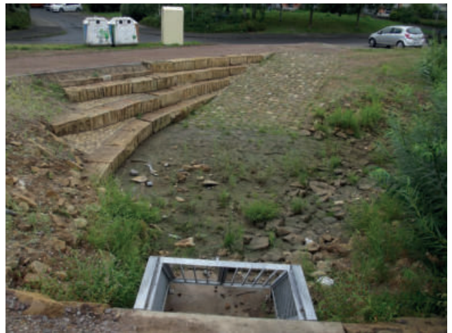
Foto 112: Die Zugänglichkeit des Rechen ist für die problemlose Beräumung unerlässlich. Eine Zufahrt erleichtert die maschinelle Beräumung. (Foto: A. Stowasser)
