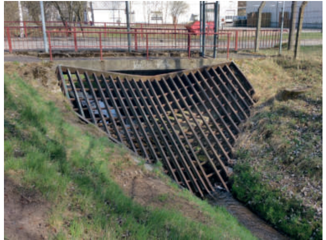
Foto 110: Treibgutrechen vor einer Brücke. Die Neigung frontaler Rechen sollte 45° nicht übersteigen. (Foto: A. Stowasser)
