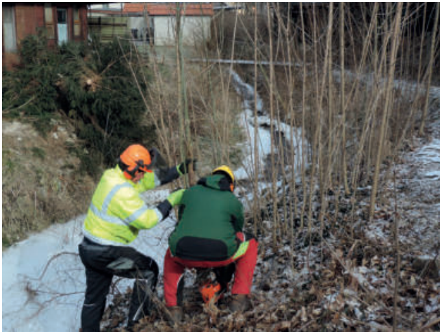
Foto 56: Um stabile Stockaustriebe zu entwickeln, muss der Rückschnitt möglichst nah an der Böschung erfolgen. (Foto: A. Stowasser).
